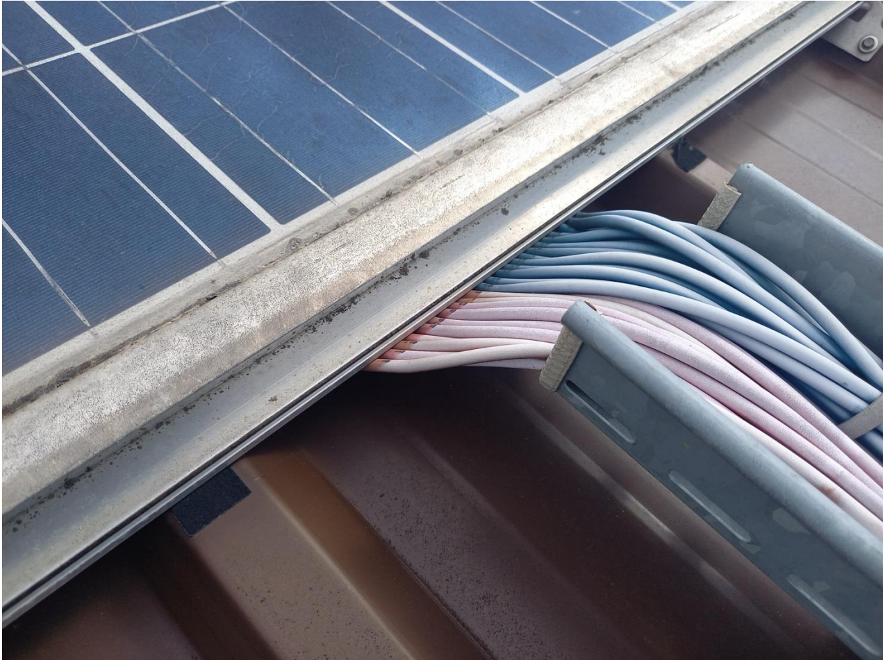
Décoloration des câbles solaires (colorés), le rouge en particulier se décolore très rapidement (source : Oliver Montalvo)
